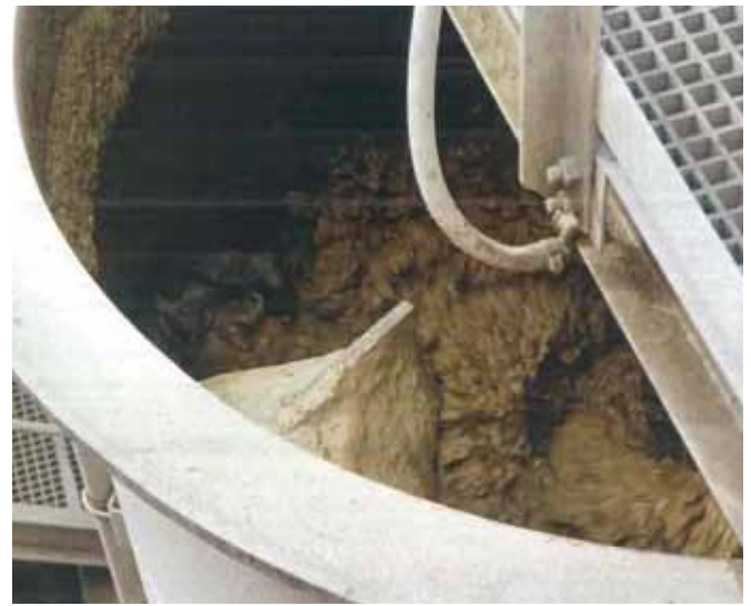
DynaWave® Effluent Bleed Tank
